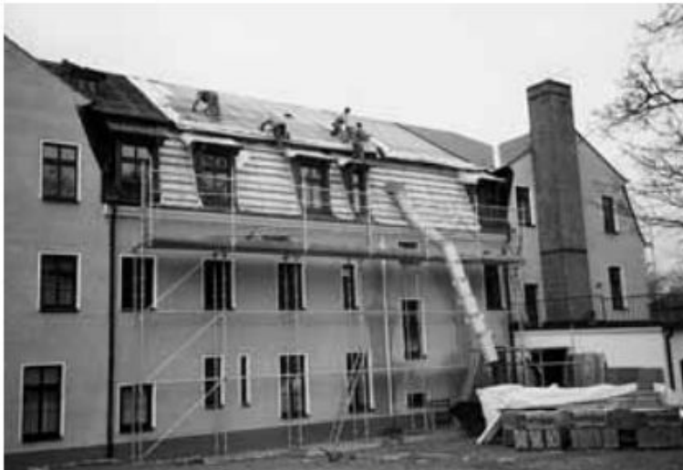
In den Jahren 1989–1992 werden Haupt- und Seitenflügel des ehemaligen St. Josefsheims zum Gäste- und Exerzitienhaus umgebaut
